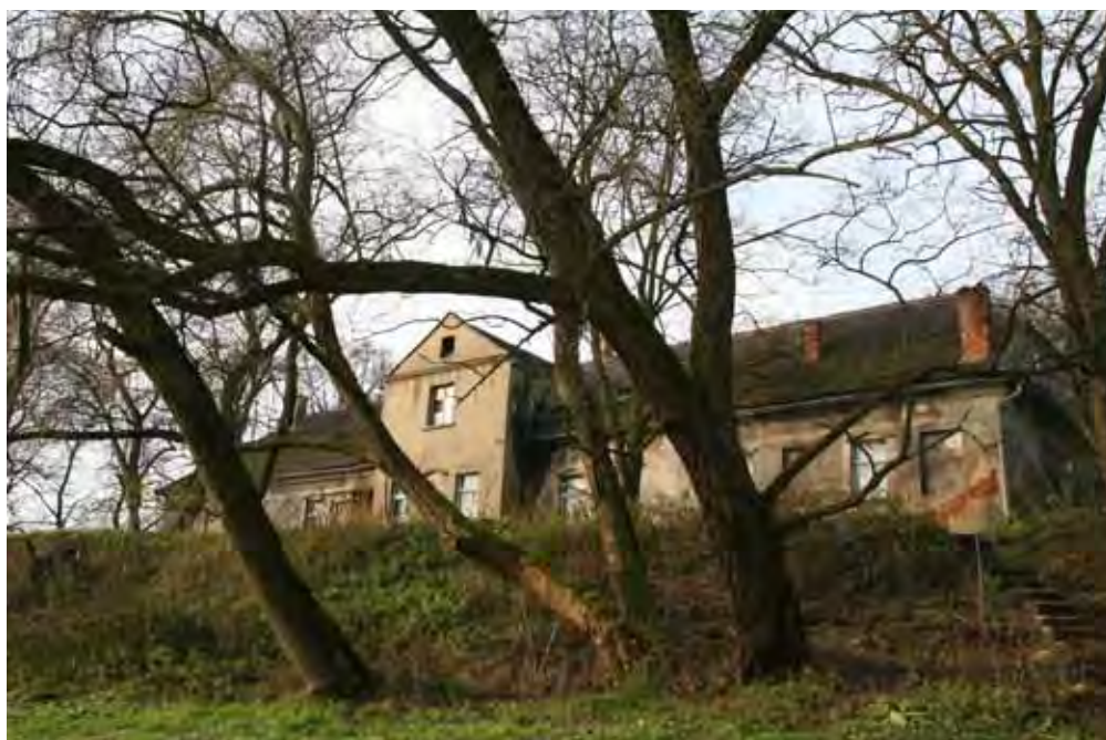
Dwór przed remontem, stan z listopada 2009 r., fot. W. Buczyński
